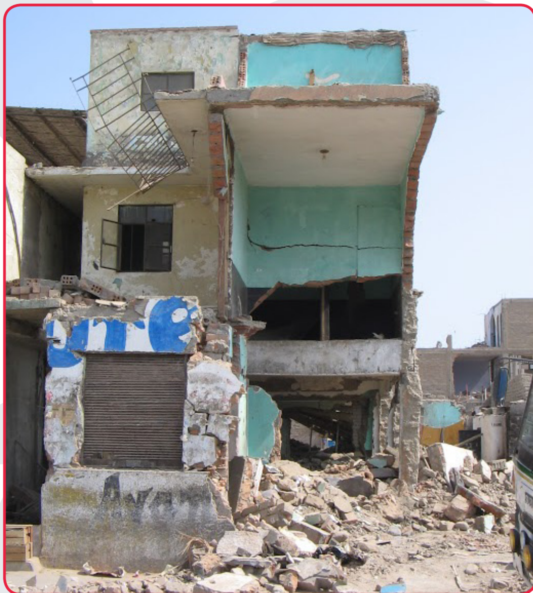
Ciudad de Pisco Post terremoto. Agosto 2007.
